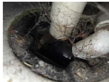
Eldre plastsluk (Begrenset inspeksjon pga dusjkabinett)
