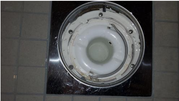
Avløpsrør (ink. sluk) - [Sluk bad 1]
