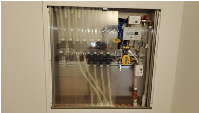
Tekniske anlegg, VVS anlegg (Sjekkpunkter utover det som er inkludert i andre rom) - [Fordelerskap for rør-i-rør-systemet]
