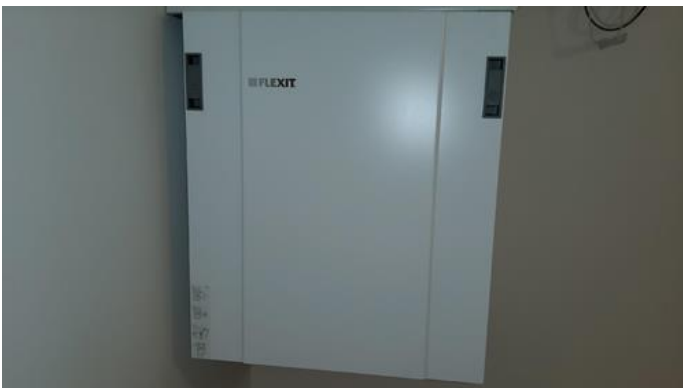
Tekniske anlegg, VVS anlegg (Sjekkpunkter utover det som er inkludert i andre rom) - [Ventilasjonsaggregat]
