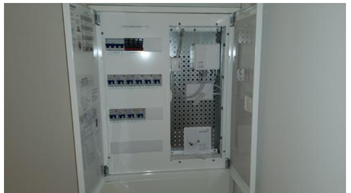
Elektrisk anlegg - [Sikringsskap]
