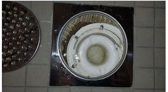
Avløpsrør (ink. sluk) - [Sluk bad 2]
