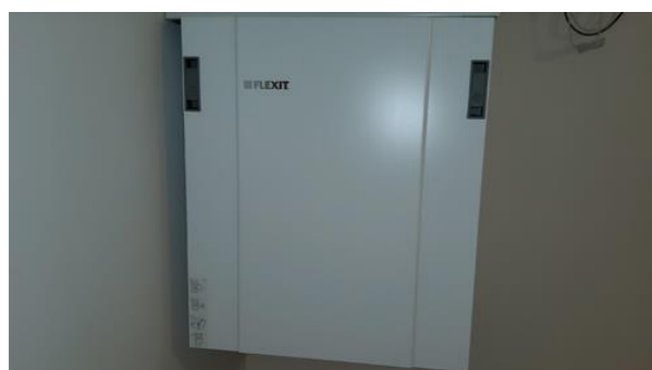
Tekniske anlegg, VVS anlegg (Sjekkpunkter utover det som er inkludert i andre rom) - [Ventilasjonsaggregat]
