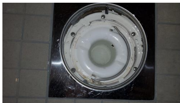
Avløpsrør (ink. sluk) - [Sluk bad 1]
