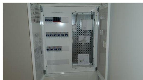
Elektrisk anlegg - [Sikringskap]
