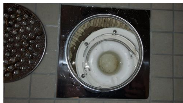
Avløpsrør (ink. sluk) - [Sluk bad 2]
