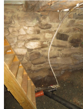
Vanninntaksledning med varmekabel.
