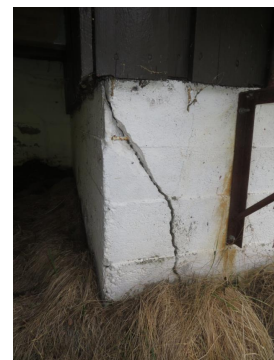
Sprekkdannelse i muren på tilbygd del pga svikt i terreng/synk i fundamentene.
