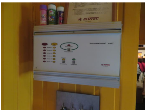
Varslingsentral for overvåkning i driftsbygning.
