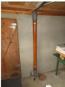
Del av avløpsrørene - stakeluke er montert.
