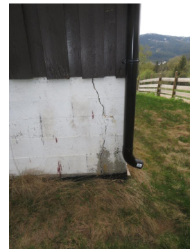
Sprekkdannelse i muren på tilbygd del pga svikt i terreng/synk i fundamentene.
