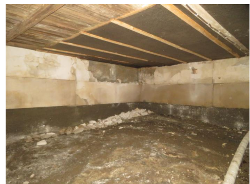
Stor fuktgjennomgang i kjellervegger - påvist skader i innført gasbetong.
