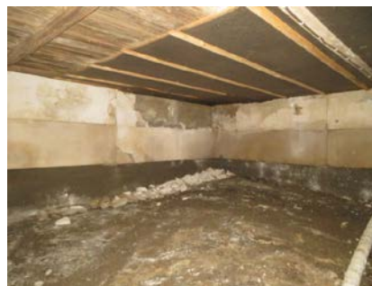
Stor fuktgjennomgang i kjellervegger - påvist skader i innforet gasbetong.
