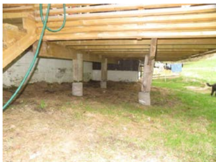
Terrasse ut for spisestue. Nyere etablert - påvist skjevhet i ett av fundamentpunktene.
