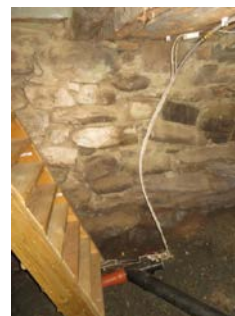
Vanninntaksledning med varmekabel.
