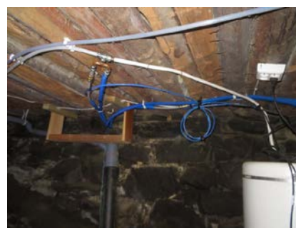
Åpent opplegg av vannledninger i jordkjeller.
