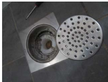
Det er ikke etablert mansjett i sluk.
