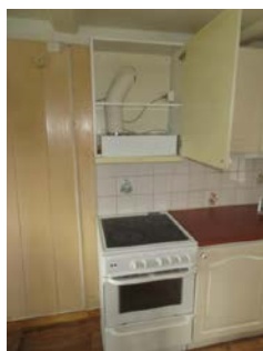
Avtrekksventilering ført ut gjennom vegg.
