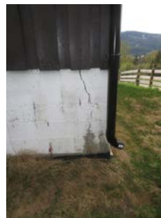
Sprekkdannelse i muren på tilbygd del pga svikt i terreng/synk i fundamentene.
