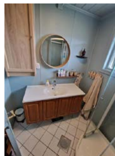
Servantskap som noe nyere - ukjent monteringsår.
