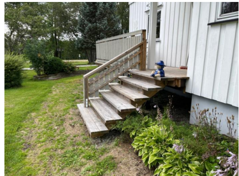
Manglende rekkverk og for lavt rekkverk.
