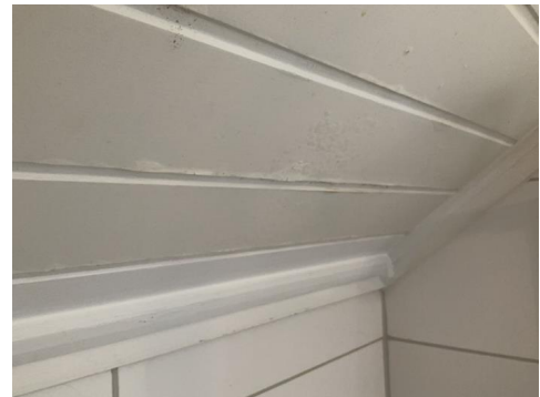
Fuktskade i tak over dusj
