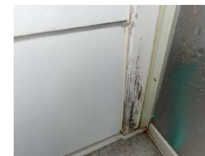
Treverk på hjørnet i dusjsone.
