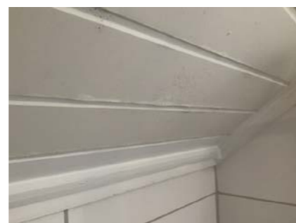
Fuktskade i tak over dusj
