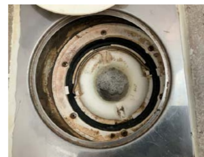
Ikke synlig mansjett i sluk.
