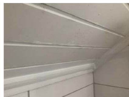
Fuktskade i tak over dusj
