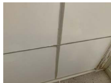
Silikon fuger på vegger?
