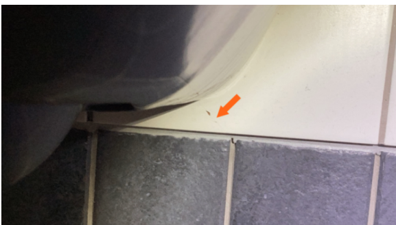
Sprekt flis under toalett.
