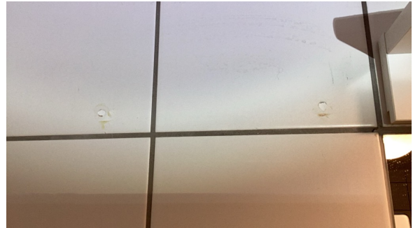
Merker i fliser etter tidligere installasjoner.
