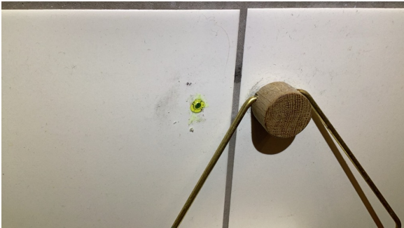
Merker i fliser etter tidligere installasjoner.
