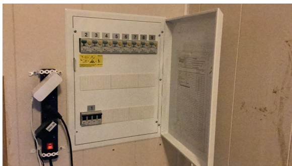
Sikringsskap i bod.
