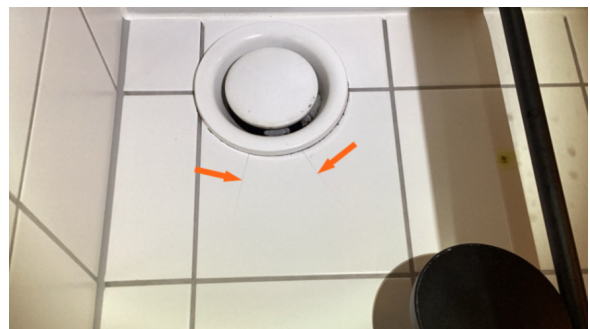
Riss/sprekk i flis ved ventil.
