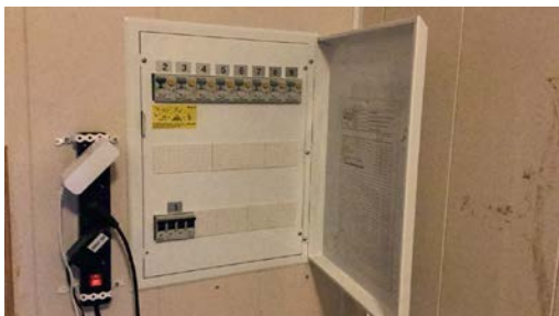
Sikringsskap i bod.
