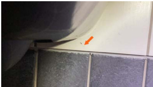
Sprekk flis under toalett.
