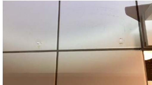
Merker i fliser etter tidligere installasjoner.
