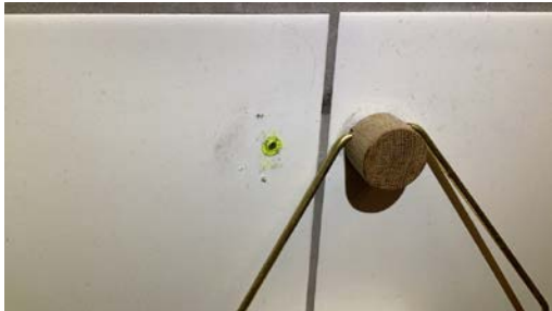
Merker i fliser etter tidligere installasjoner.
