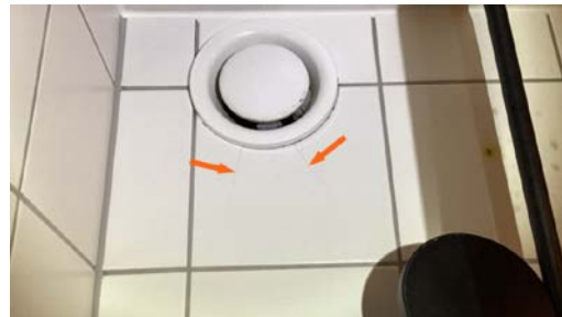
Riss/sprekk i flis ved ventil.
