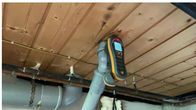
Fuktmåling i takpanel rundt avløpsrør i kjeller.
