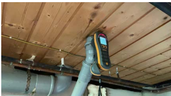
Fuktmåling i takpanel rundt avløpsrør i kjeller.
