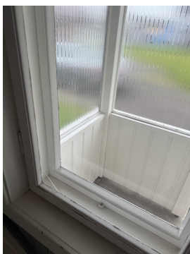
Vindu med koblet glass med sprekk ved inngangsparti
