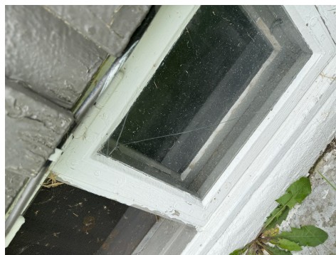
Kjellervindu med sprekk i glass
