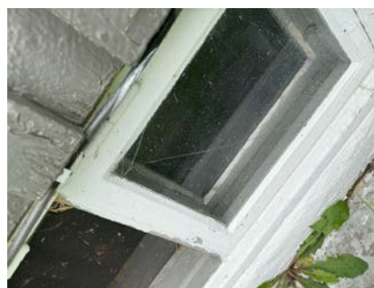
Kjellervindu med sprekk i glass
