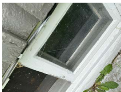
Kjellervindu med sprekk i glass
