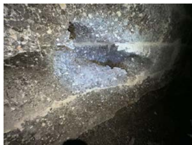
Oppsmuldring fra innvendig side av grunnmur.
