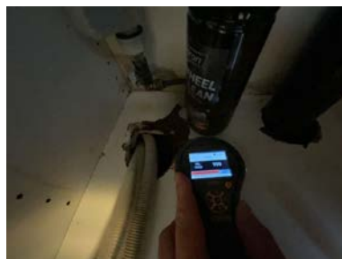
Lekkasje fra vannledning i benkeskap
