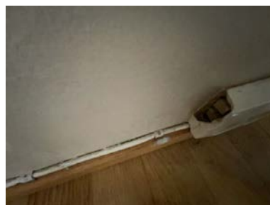
Skade på deksel i stue.
