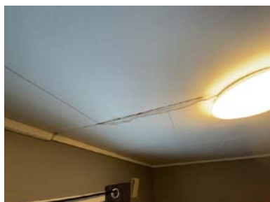
Løs kabel til taklampe.
