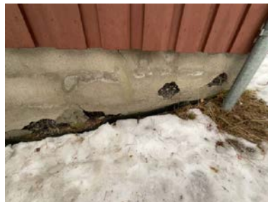
Oppsmuldring fra utvendig side av grunnmur.
