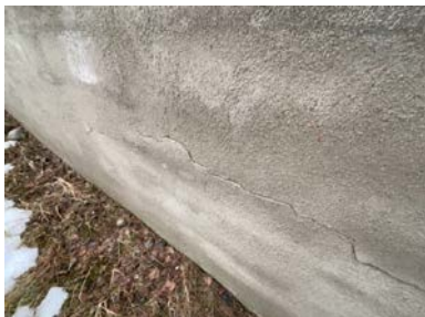
Sprekker i grunnmur.
