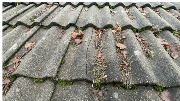
Sprekk i takstein.
