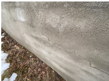
Sprekker i grunnmur.
