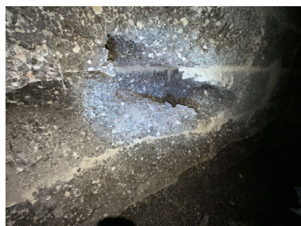
Oppsmuldring fra innvendig side av grunnmur.
