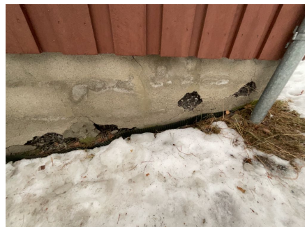
Oppsmuldring fra utvendig side av grunnmur.
