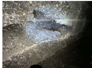
Oppsmuldring fra innvendig side av grunnmur.
