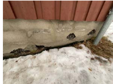
Oppsmuldring fra utvendig side av grunnmur.
