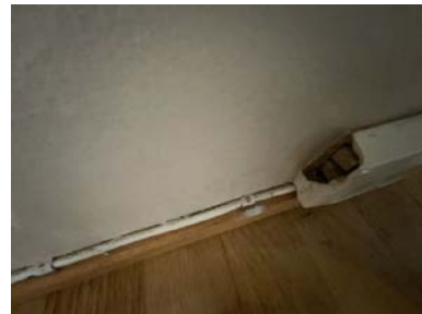
Skade på deksel i stue.
