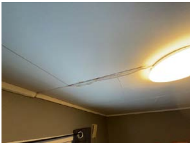
Løs kabel til taklampe.
