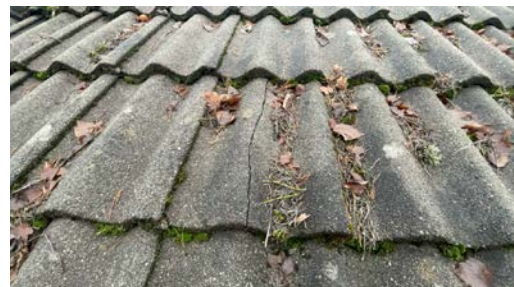
Sprekk i takstein.
