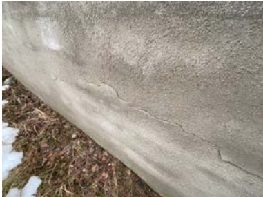
Sprekker i grunnmur.
