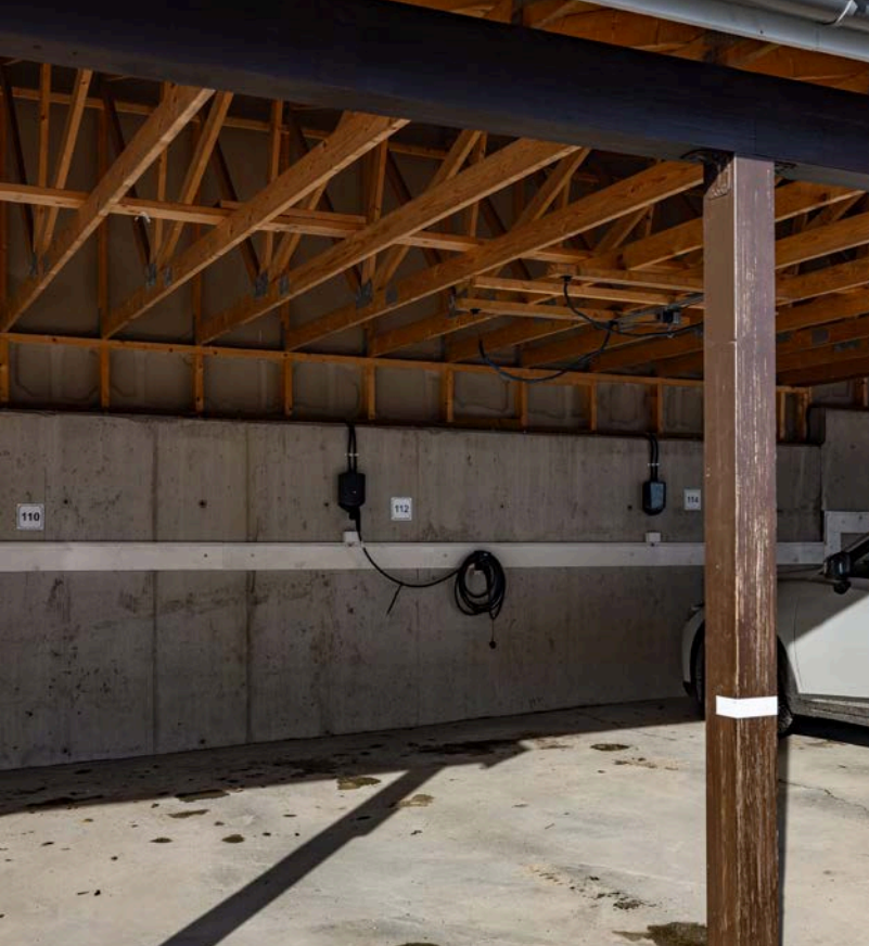
Leiligheten disponerer biloppstillingsplass i felles carportanlegg. Det er montert elbil-lader på plassen.
