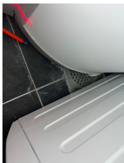
Under varmvannstank og vaskemaskin.
