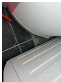
Under varmtvannstank og vaskemaskin.
