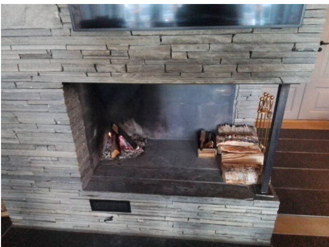
flekker på skifer over og under peis åpning
