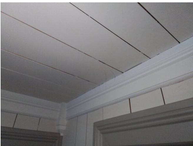
sot i speindelnev i tk, behov for vask for fjerning av lukt og sot
