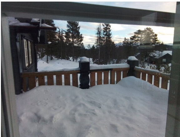
Behov for vask av vinduer etter pipebrann
