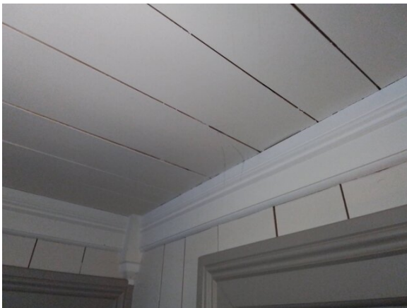
sot i speindellev i tk, behov for vask for fjerning av lukt og sot
