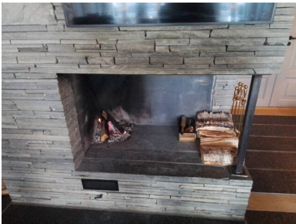
flekke på skifer over og under peis åpning
