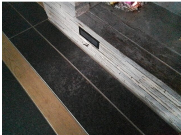
flekker på gulv skifer etter slukking
