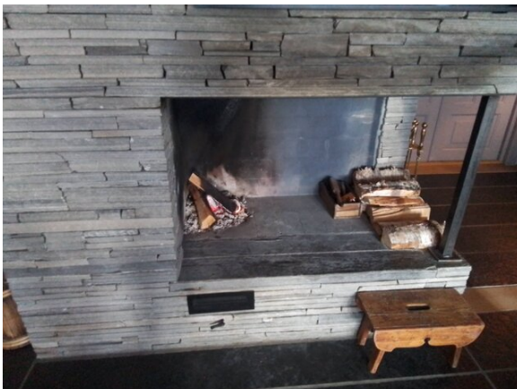
Peis i stue, her kom røyk og pulver ut under slukking av pipebrann, sotskader på skifer stein over og under åpning
