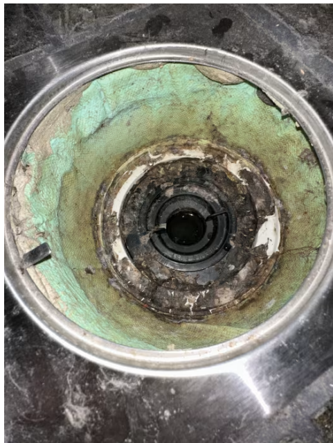
Viser sluk under dusjkabinett.
