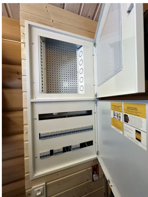
Viser sikringsskap plassert i bod. Avdekking, kursfortegnelse og lokk på koblingsboks blir utført før salg.
