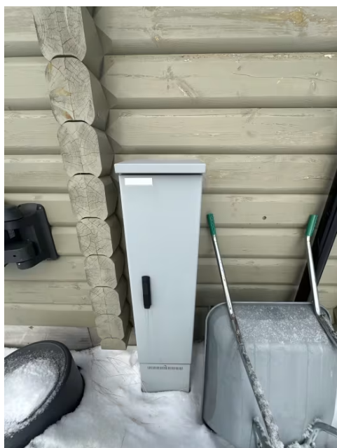
Viser utvendig målerskap.
