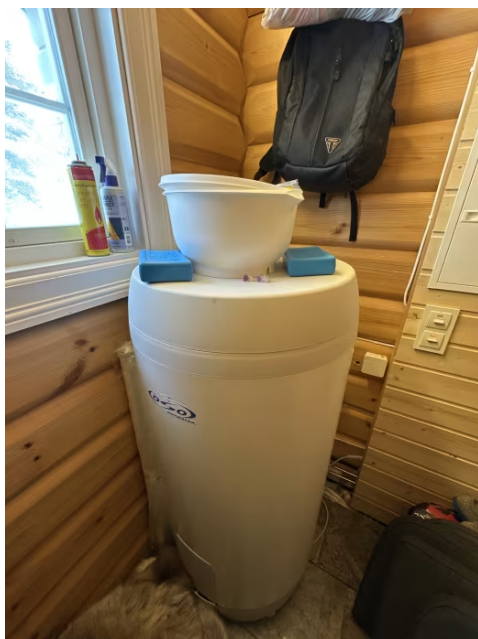
Viser bereder plassert i bod.
