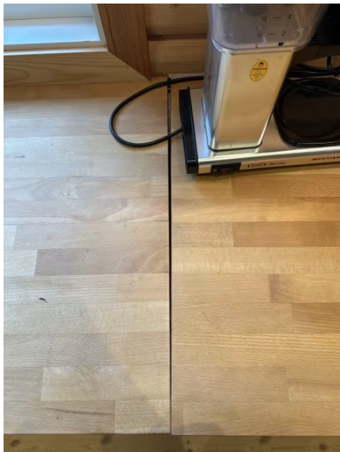
Det registreres mindre glippe i benkeplate.
