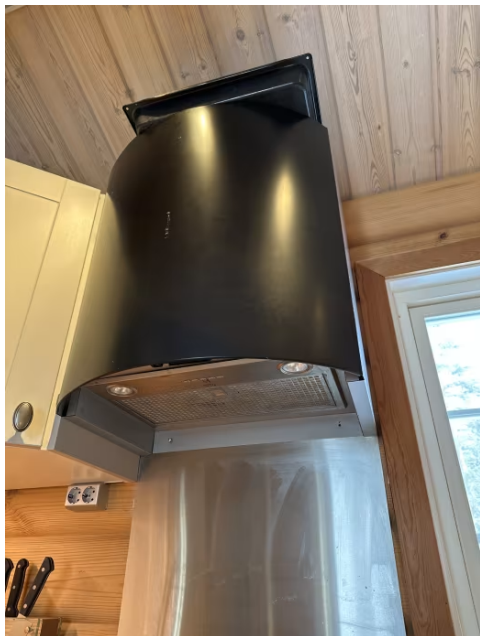
Viser ventilator på kjøkkenet.
