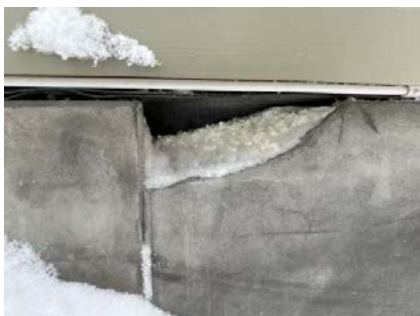
Det registreres stedvis sprekker og avskalling i grunnmursplater.
