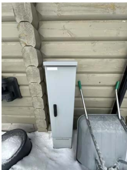
Viser utvendig målerskap.
