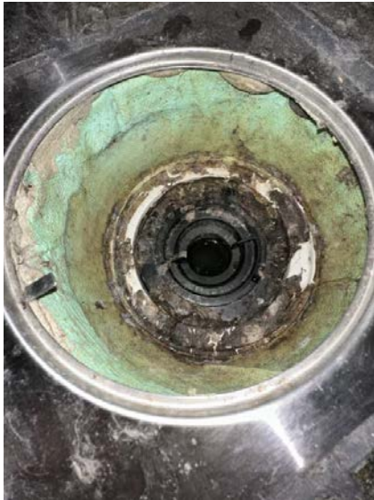
Viser sluk under dusjkabinett.
