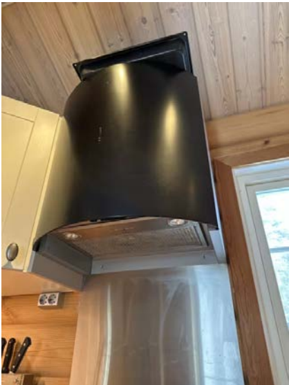
Viser ventilator på kjøkkenet.
