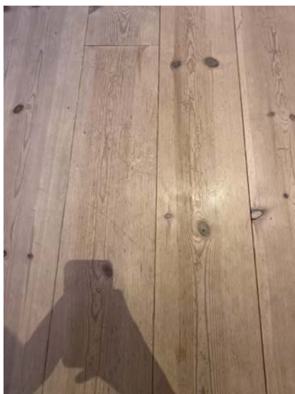
Det registreres slitasje på tregulvet.
