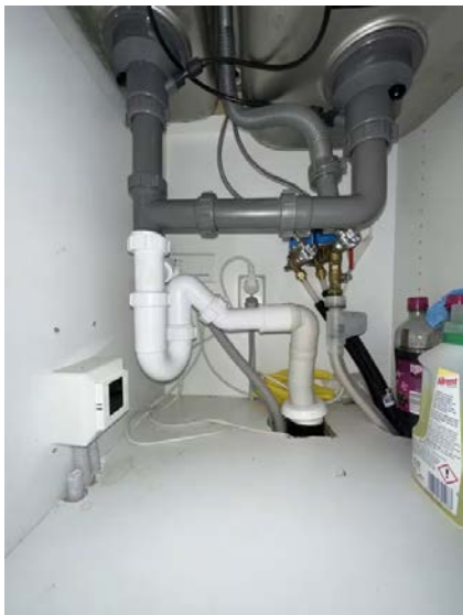
Viser vann og avløpsinstallasjoner under kum.
