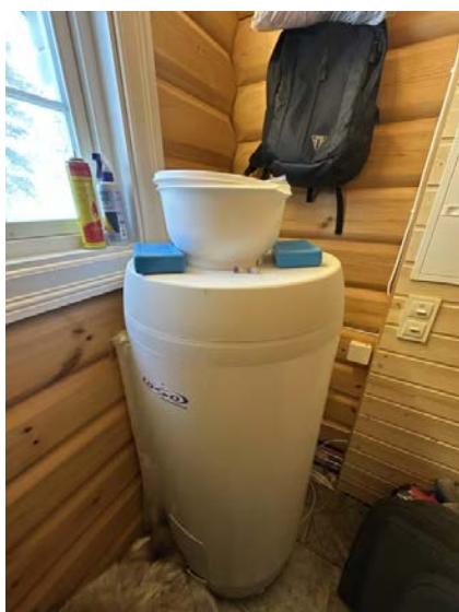
Viser bereder plassert i bod.
