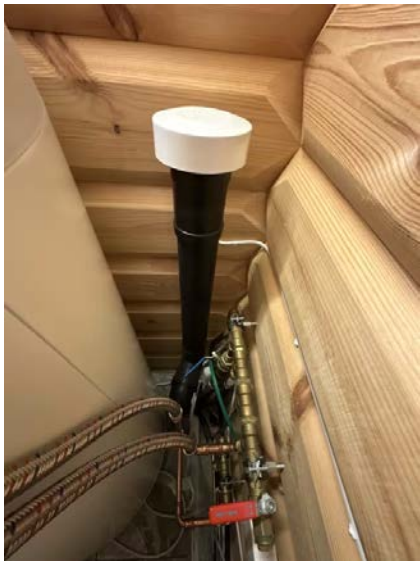
Lufting av avløpsanlegget med durgventil plassert i bod.
