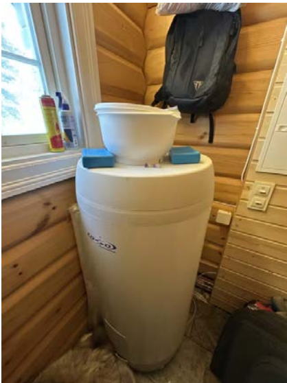
Viser bereder plassert i bod.
