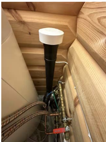
Lufting av avløpsanlegget med durgoventil plassert i bod.
