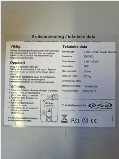
Viser teknisk data på bereder.
