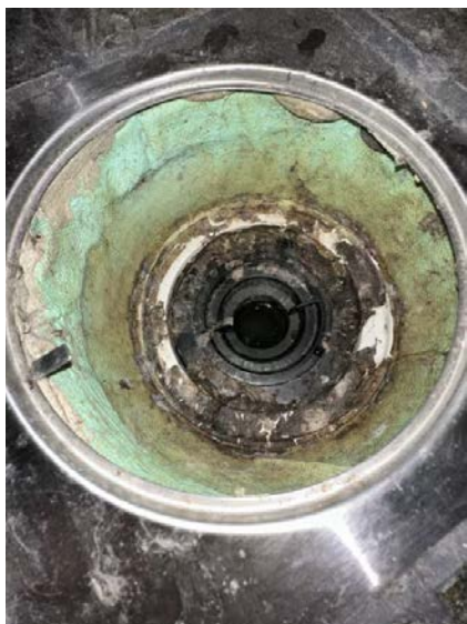
Viser sluk under dusjkabinett.
