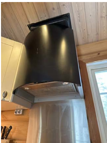
Viser ventilator på kjøkkenet.
