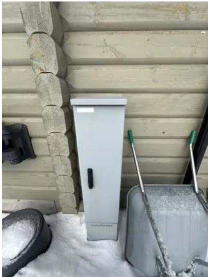
Viser utvendig målerskap.
