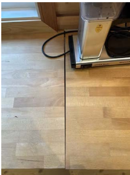
Det registreres mindre glippe i benkeplate.
