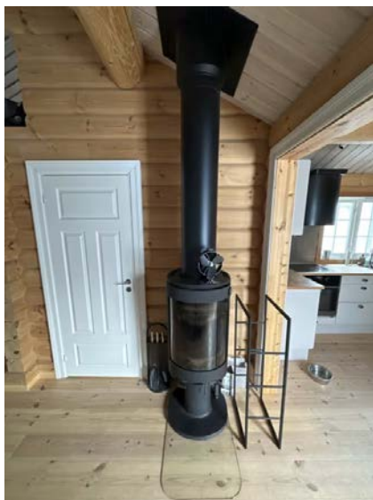
Viser ildsted montert i stue
