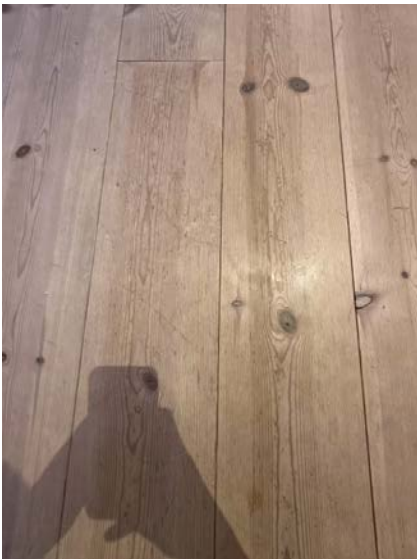
Det registreres slitasje på tregulvet.
