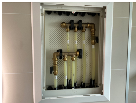
Rør i rør skap på baderom
