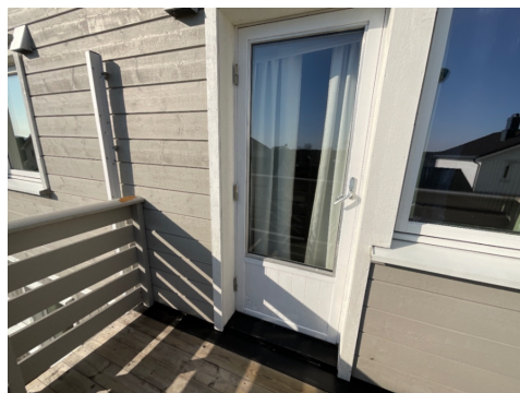
Balkongdør i 2. etasje
