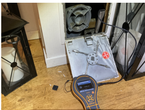
Fukt måling mot vaskerom i inspeksjonsluke 16. april 2026
