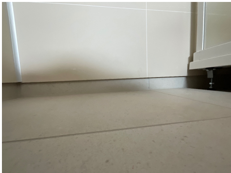
Manglende aluminiumslist og fugemasse
