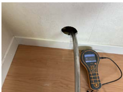
Fuktmåling i soveromsvegg 16. april 2026
