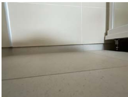
Manglende aluminiumslist og fugemasse
