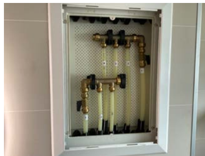
Rør i rør skap på baderom
