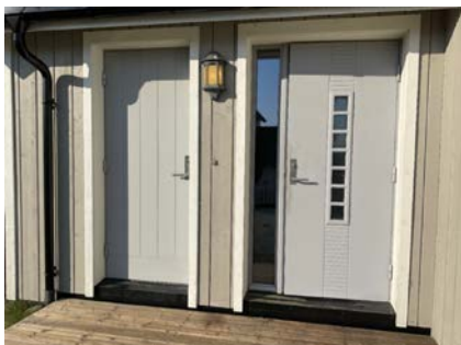
Inngangsdør og boddør
