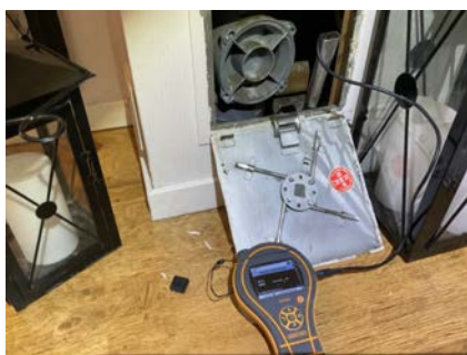
Fukt måling mot vaskerom i inspeksjonsluke 16. april 2026
