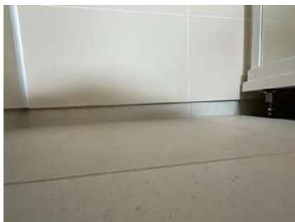
Manglende aluminiumslist og fugemasse
