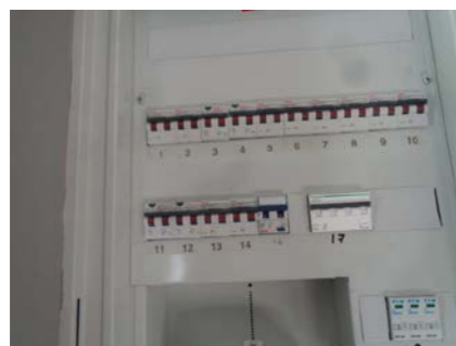
Sikringsskap i entrè.
