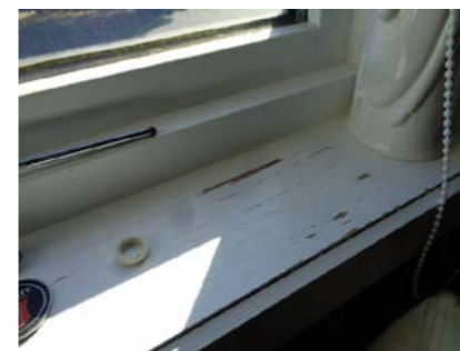
Slitasje på foringer.
