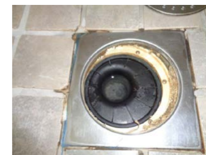
Plastsluk i dusjsone.
