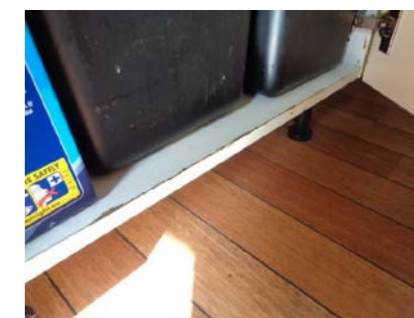
Slitt slitasje på skrog i skap under vask.
