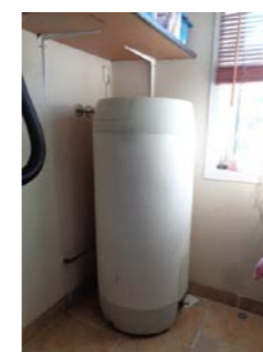
Varmtvannsbønder på vaskerom.
