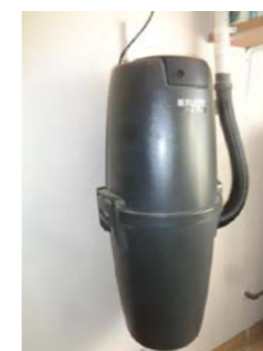
Sentralstøvsuger på vaskerom.
