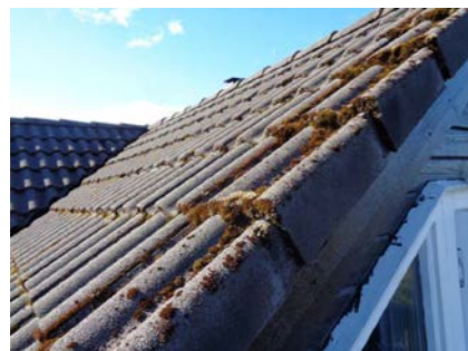
Noe mose på yttertak.
