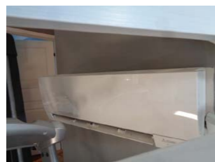
Varmepumpe i entré.
