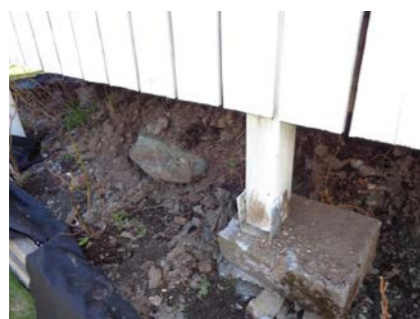
Tresøyler står ikke innpå søylesko.
