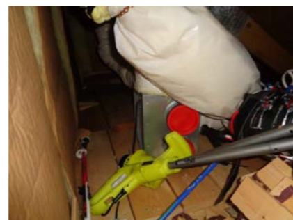
Motor til ventilasjon i knevegg.
