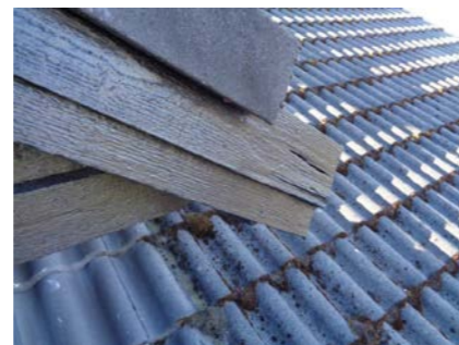
Noe dårlige vindskier.
