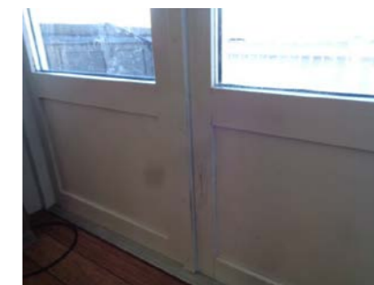
Skrapemerke på altandør.
