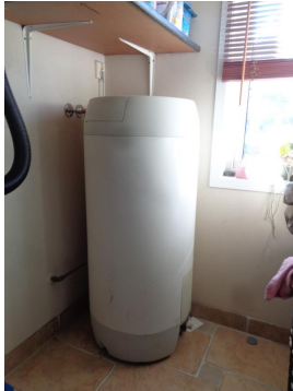
Varmtvannsbereder på vaskerom.
