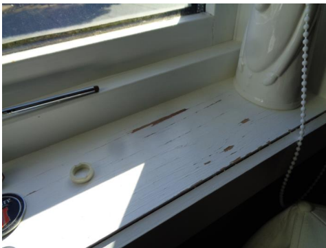
Slitasje på foringer.
