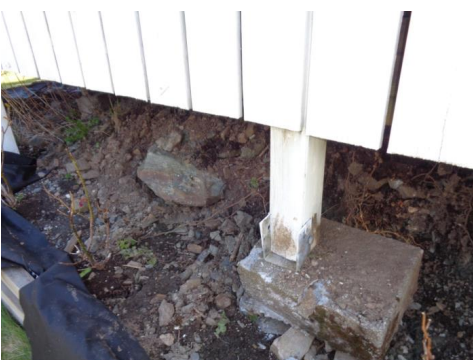
Tresøyler står ikke innpå søylesko.
