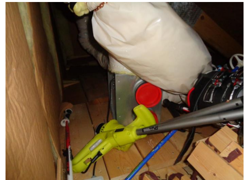
Motor til ventilasjon i knevegg.
