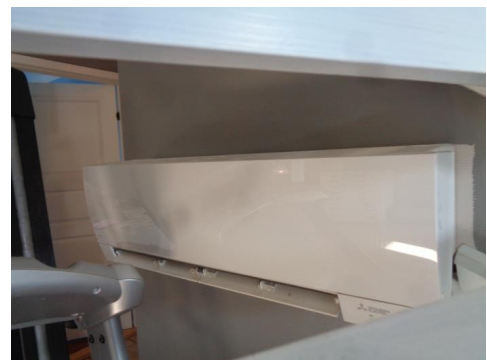
Varmepumpe i entré.
