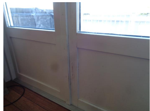
Skrapemerker på altandør.
