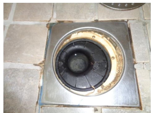
Plastsluk i dusjsone.
