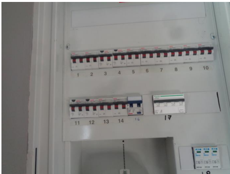
Sikringskap i entrè.
