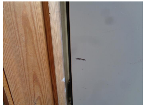
Merke på ytterdør til carport.
