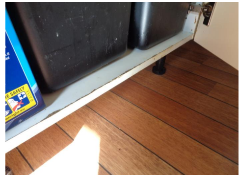
Slitt slitasje på skrog i skap under vask.
