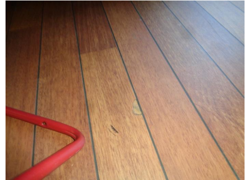
Skade på gulv i stue.
