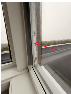
Bildet viser vindu mangler utvendig klemliste.
