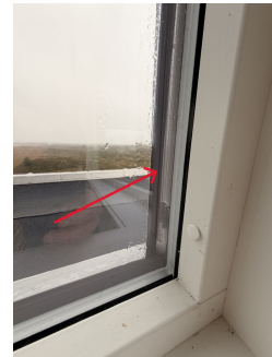
Bildet viser vindu har utvendig klemliste som er løsnet.
