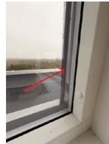
Bildet viser vindu har utvendig klemliste som er løsnet.
