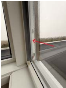
Bildet viser vindu mangler utvendig klemliste.
