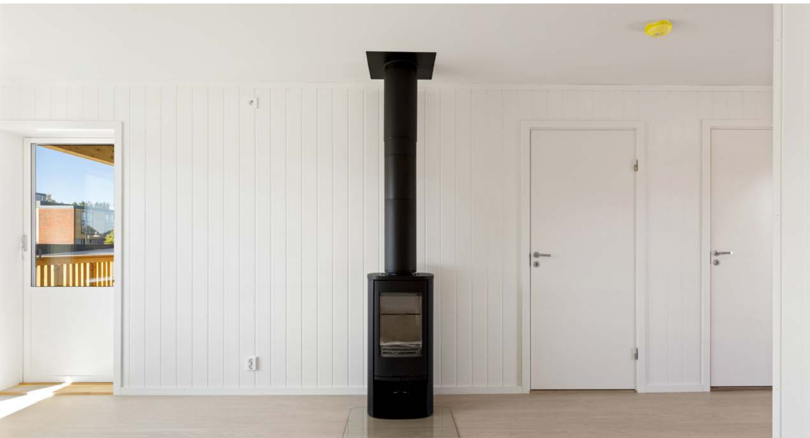
Boligens varmeanlegg består av elektriske panelovner, varmekabler på bad og en peisovn i stue.
