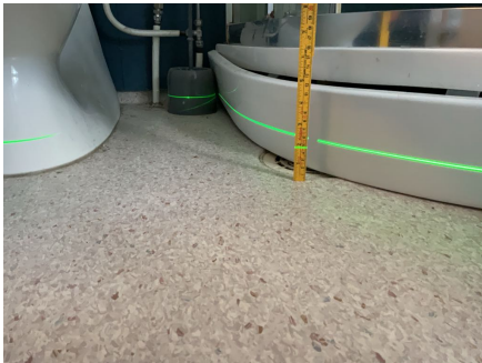
Manglende fall til sluk.
