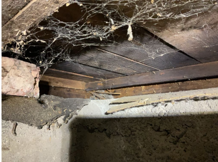
Noe misfarging på stubbloft.
