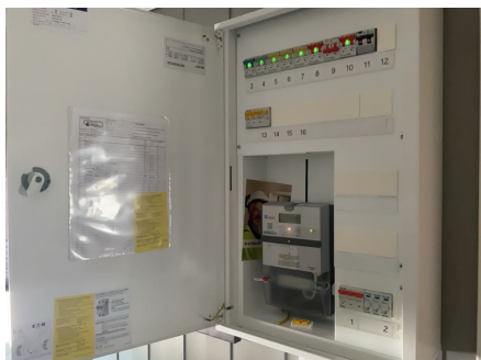
Sikringsskap plassert i gang loftsetasje
