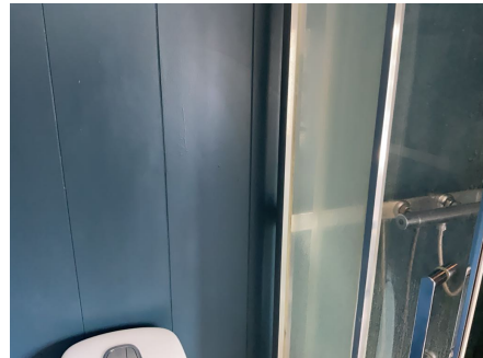
Vegger er ikke utført med fuktsikre overflater i våtsoner.
