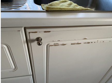
Svelling på innredning.
