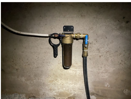
Stoppekran plassert i kjeller.
