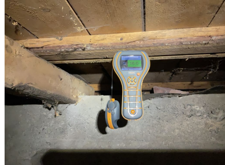
Ved fuktmåling registrerte jeg risikable verdier for skadelig fukt, det indikerer at konstruksjonen er utsatt for fuktpåkjenning.
