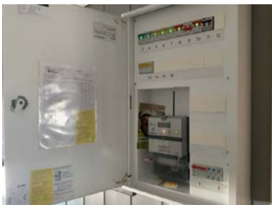
Sikringsskap plassert i gang loftsetasje
