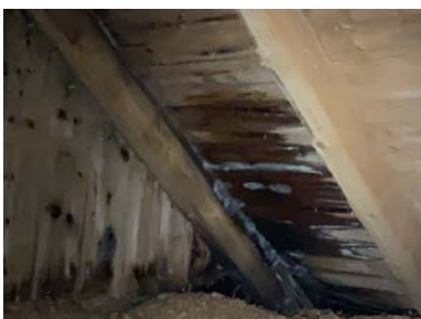
Fuktmerker og ising på undertak i området over bad. Årsak er trolig varmluft/kondens ut på vegg fra bad og dårlig ventilering av loft. Anbefaler ytterligere undersøkelser.
