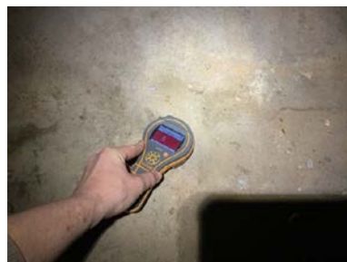
Ved enkle fuktsøk ble det registrert områder med forhøyde verdier.
