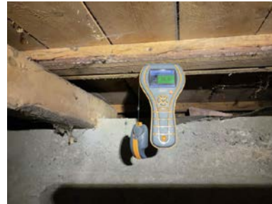
Ved fuktmåling registrerte jeg risikable verdier for skadelig fukt, det indikerer at konstruksjonen er utsatt for fuktpåkjenning.
