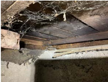
Noe misfarging på stubbloft.
