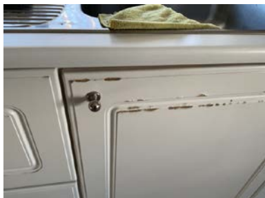
Svelling på innredning.
