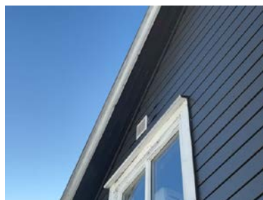
Maling flasser over ventil på bad, hvor treffpunkt for ventilering på bad er.
