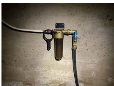
Stoppekran plassert i kjeller.
