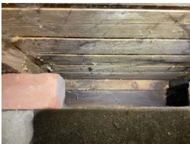
Misfarging på bunnsvill registrert.
