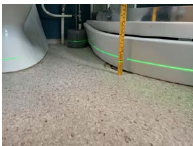
Manglende fall til sluk.
