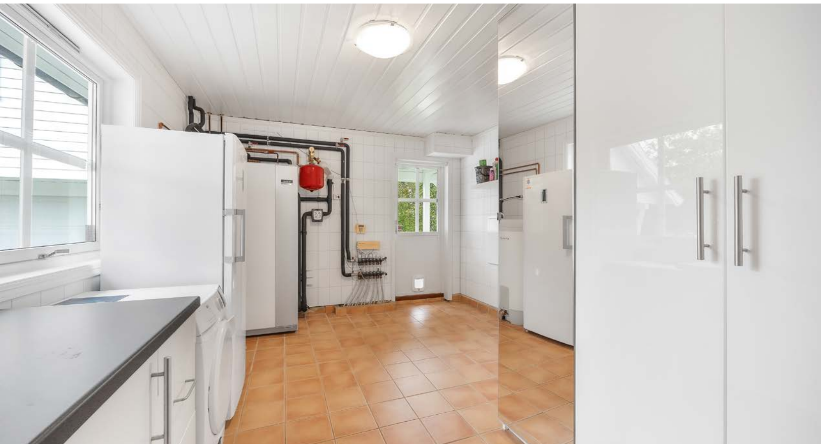
Her er det opplegg for vaskemaskin og tørketrommel. Det er også en egen, utvendig adkomst.
