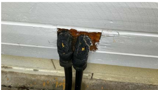
Det mangler beslag/utvendig tetting ved rørgjennomføring i vegg.
