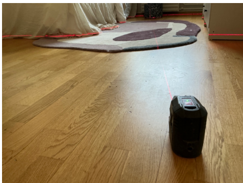
Nivellering soverom, avvik ca. 30 mm gjennom hele rommet
