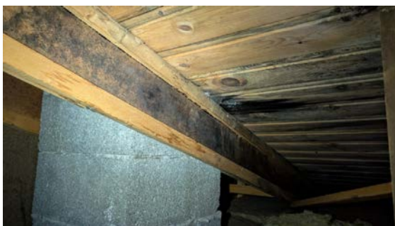
Lekkasje ved pipe som skal være utbedret.
