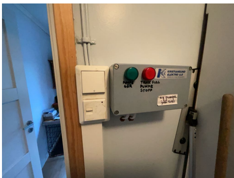
Styrepanel for høytrykkspumpe plassert på vaskerom.
