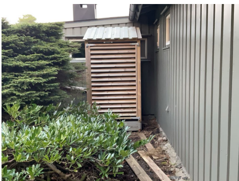
Luft til vann varmepumpe.
