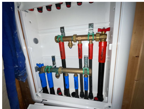
rør i rør sentral.
