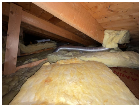
Ventilasjonsrør/flexirrør er ikke isolert på kaldloft.
