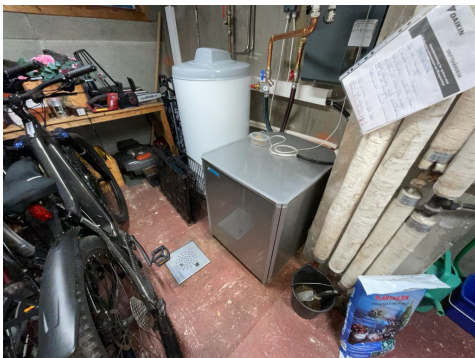
Varmtvannsbereder plassert i teknisk rom ved garasje.
