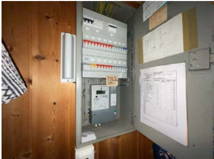
Sikringsskap plassert i entre.
