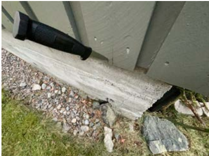
Stedvis mindre tørke/råteskader i nedre del av bordkledning mot vest
