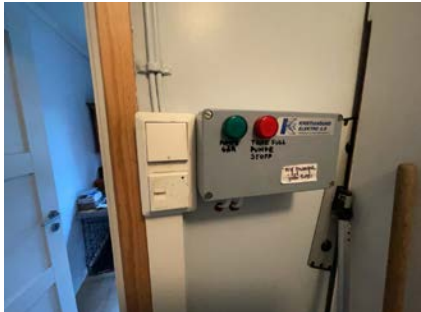
Styrepanel for høytrykkspumpe plassert på vaskerom.
