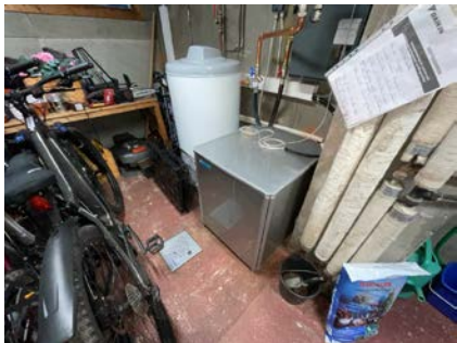
Varmtvannsbereder plassert i teknisk rom ved garasje.
