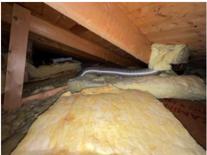
Ventilasjonsrør/flexirør er ikke isolert på kaldloft.
