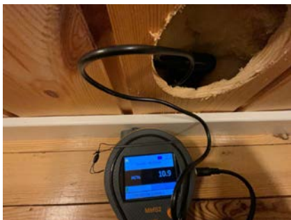
Piggmåling viste 10,9 vekt% ved kontrollmåling i gang bak dusjnise.
