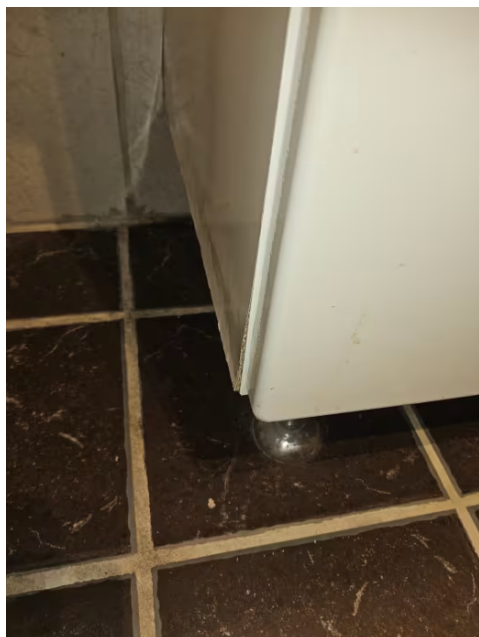
Fuktskader på servantinnredning.
