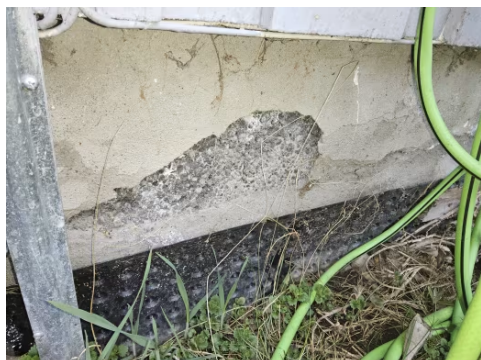
Det registreres avskalling av murpuss på grunnmuren.
