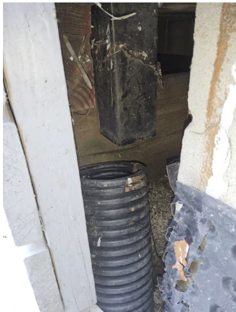
Taknedløp ved terrasse er ikke ført til drensør.
