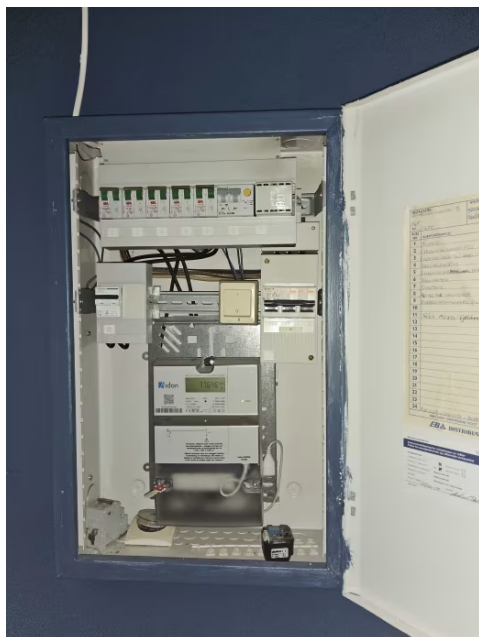
Sikringsskap er plassert i stue.
