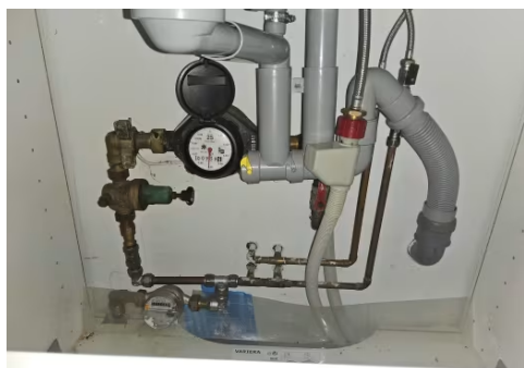
Leiligheten har synlige vannrør av kobber.
