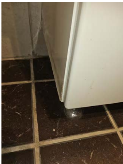
Fuktskader på servanttinnredning.
