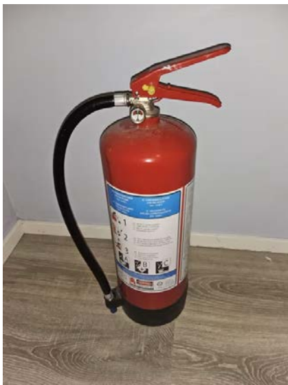
Leiligheten har brannslukningsapparat.
