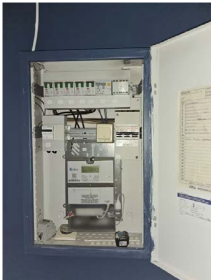
Sikringsskap er plassert i stue.
