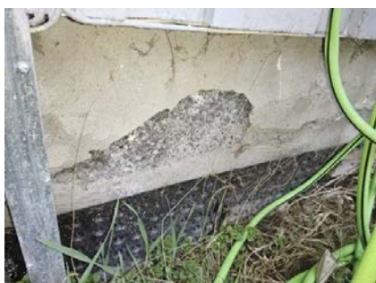
Det registreres avskalling av murpuss på grunnmuren.
