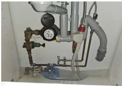
Leiligheten har synlige vannrør av kobber.
