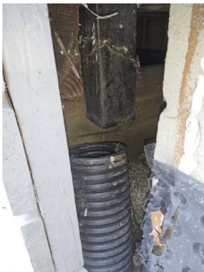
Taknedløp ved terrasse er ikke ført til drenerør.
