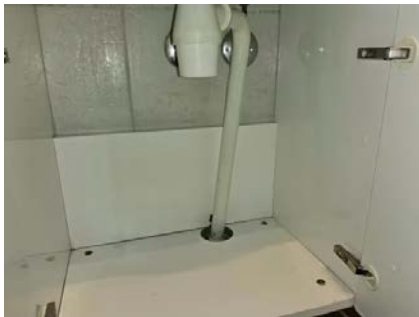
Leiligheten har synlige avløpsrør av plast.
