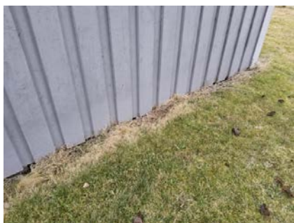
Kledning på bod er avsluttet nærme bakken.
