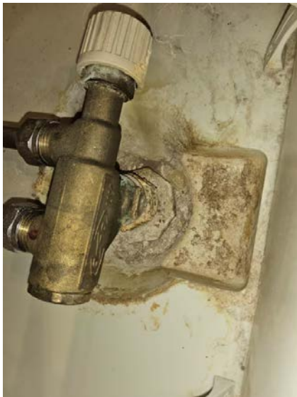
Det registreres korrosjon på rørkoblinger på berederen.
