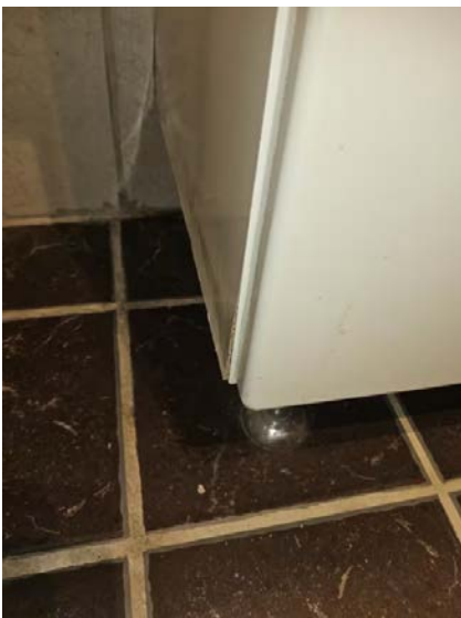
Fuktskader på servanttinnredning.
