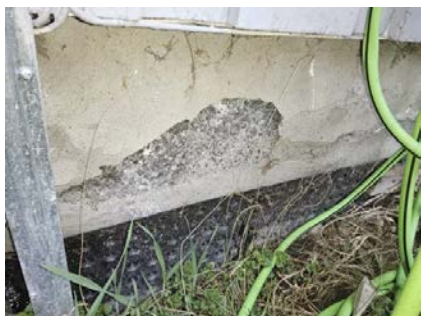
Det registreres avskalling av murpuss på grunnmuren.
