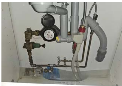
Leiligheten har synlige vannrør av kobber.
