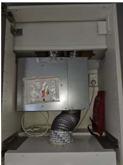
Mekanisk avtrekksvifte plassert i overskap på
