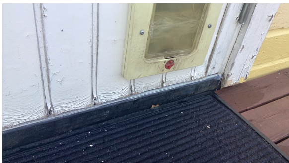
Slitasje på verandadør.
