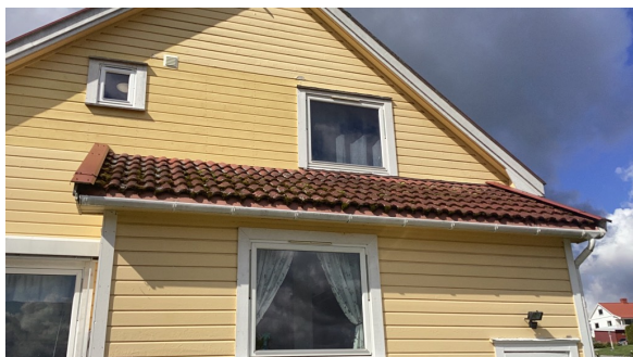
Det er ikke helhetlig overgang med beslag mot tilbygg.
