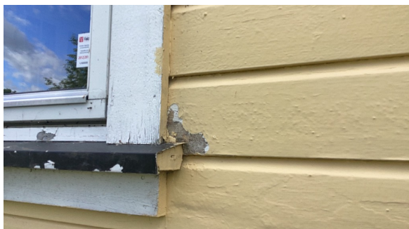
Eksempel på slitasje.
