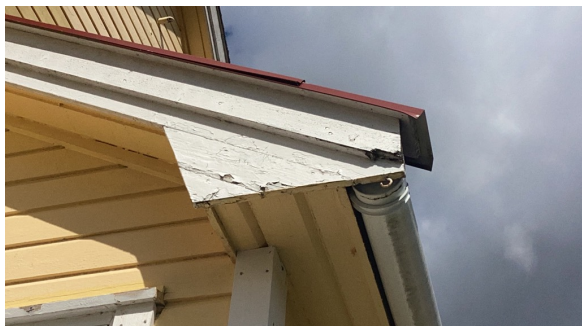
Stedvis utvendig slitasje.
