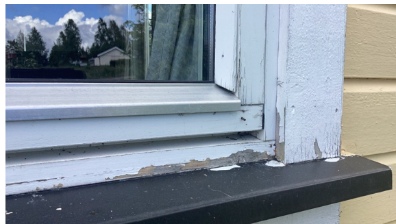
Eksempel på slitasje.
