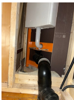
Det er ikke helhetlig membran innkassing for toalett.
