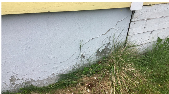
Eksempel på sprekk i grunnmur.
