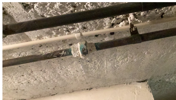
Stedvis korrosjon på skjøter
