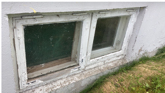
Eksempel på slitasje.
