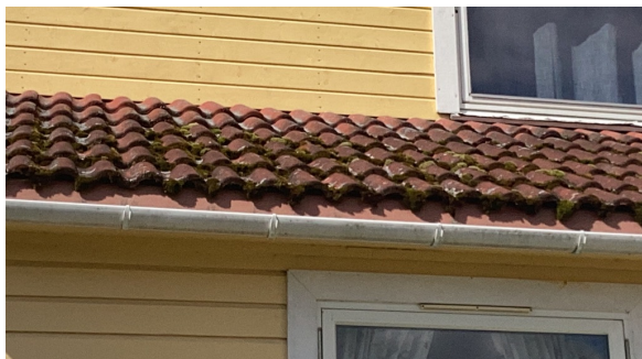
Stedvis kraftig mosevekst.
