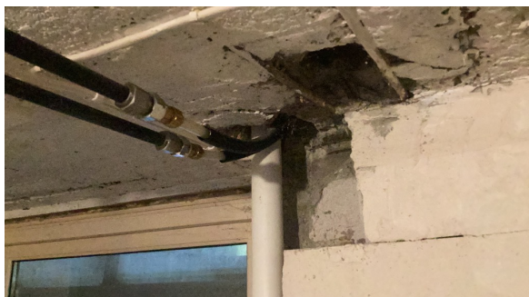
Rør i rør er avsluttet i rom uten sluk i kjeller.
