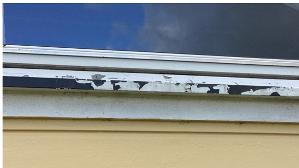
Avskaling på vannbrettbeslag.
