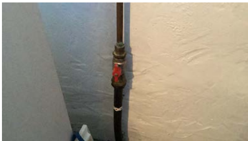
Vanninntak med stoppekran
