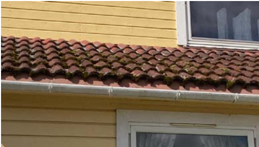
Stedvis kraftig mosevekst.
