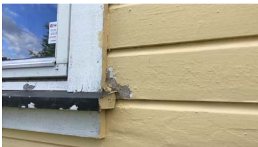
Eksempel på slitasje.
