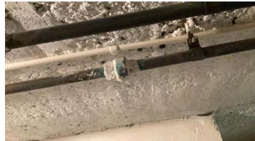
Stedvis korrosjon på skjøter
