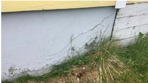
Eksempel på sprekk i grunnmur.
