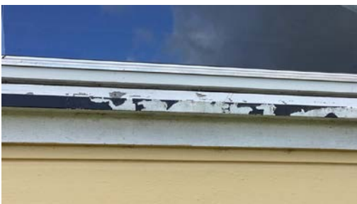
Avskaling på vannbrettbeslag.
