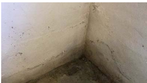
Eksempel på fuktpåkjenninger.
