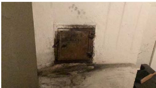
Sotluke i kjeller.
