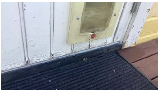
Slitasje på verandadør.
