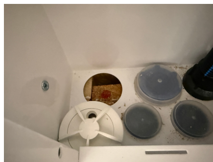
Viser manglende avløp, samt sensor
