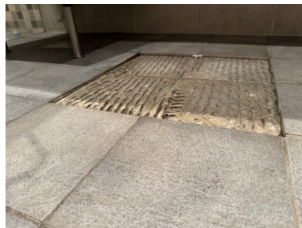
Løse fliser på badegulv
