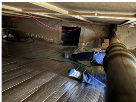
Viser avløpsrør i krypkjeller
