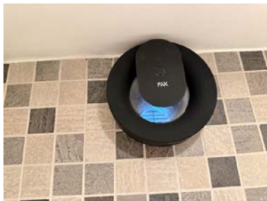
Avtrekksvifte fra badet
