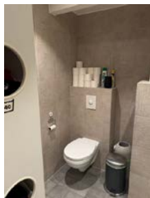
Viser del av badet med wc og innebygget varmtvannsbereder.
