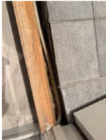
Viser membran som ligger lavere enn gulvet ved dørterske
