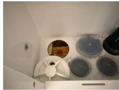
Viser manglende avløp, samt sensor
