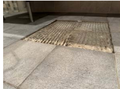
Løse fliser på badegulv
