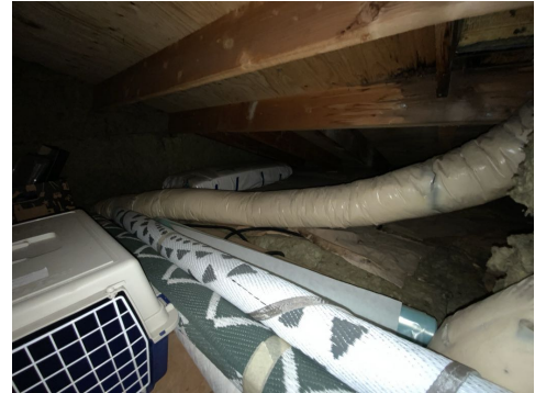
Stedvis misfarget undertak.
